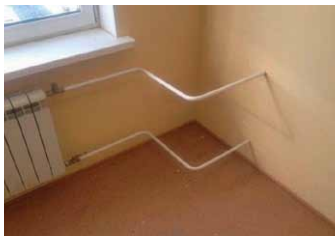
Фигурная установка отопительных систем
