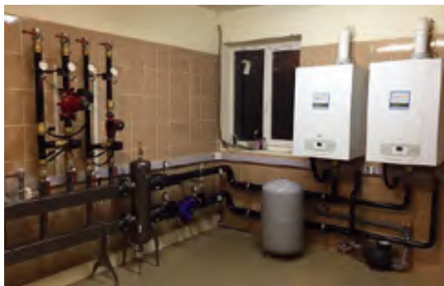
Автосервис, г. Москва Общая мощность котельной - 300 кВт
