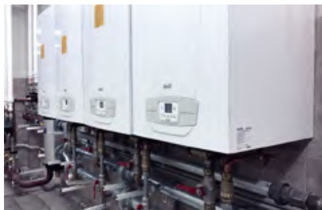
Общежитие, г. Усть-Луга Общая мощность котельной - 300 кВт
